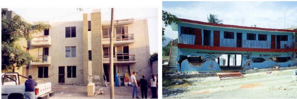
Figura 5 Agrietamiento concentrado en la planta baja (Alcocer et al., 2003; Jara et al., 2005)
