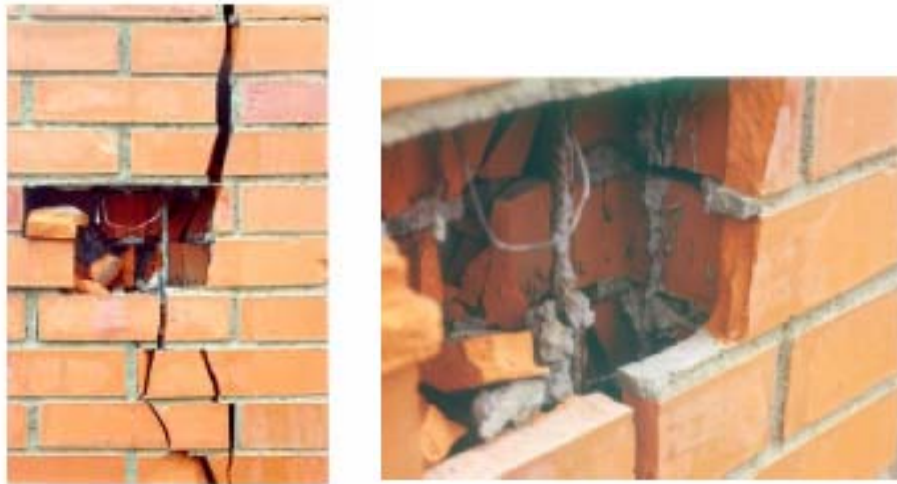
Figura 7 Inadecuado colado de castillo interno en un muro construido con piezas extruídas (Alcocer et al., 1999).
