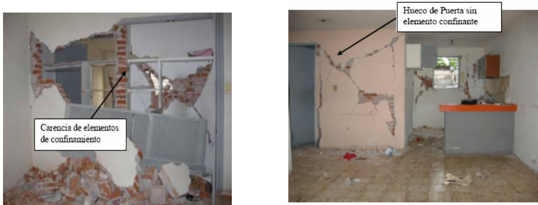
Figura 2 Falta de confinamiento e inadecuada conexión de mampostería con elementos confinantes (Alcocer et al., 2003)
