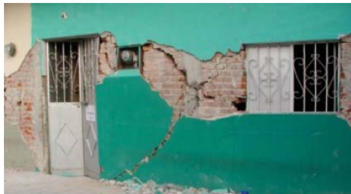
Figura 3 Falta de confinamiento en aberturas (Alcocer et al., 2003)
