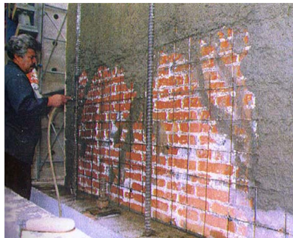
Figura 30 Saturación de los muros de mampostería colocación del mortero para recubrir la malla de alambre (Ruiz, 1995)
