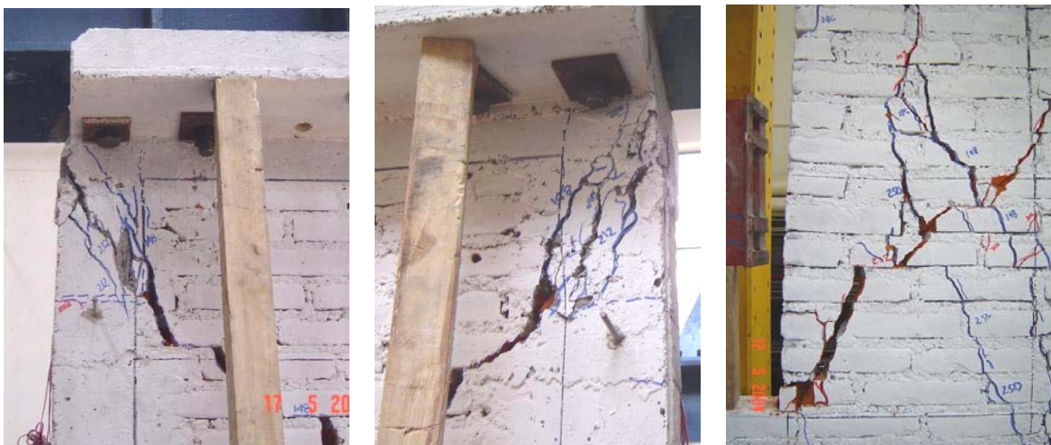
Figura 3 Daño en castillos y en el panel de mampostería
